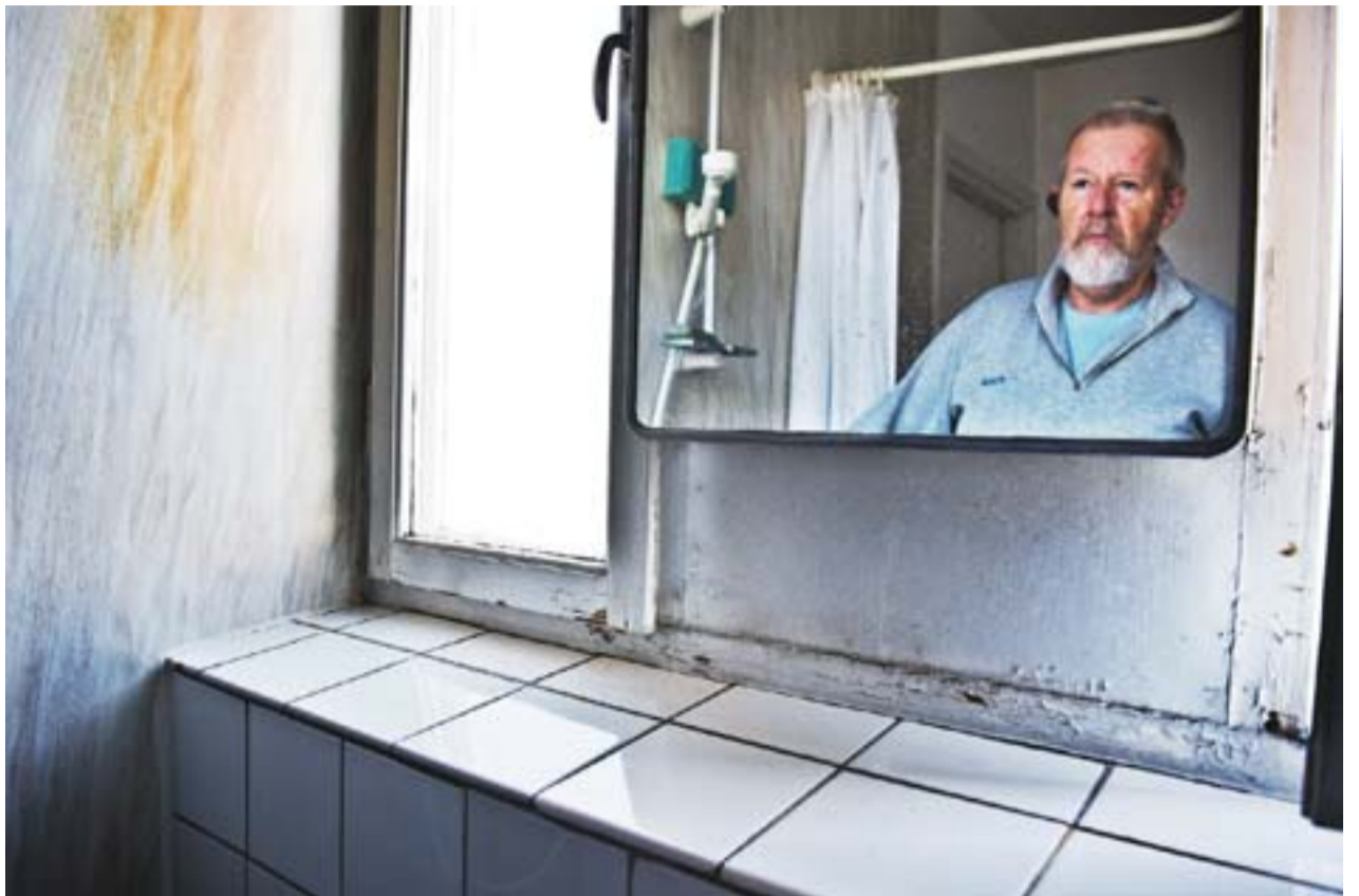
Efter flera påstötningar fick Sten Frölund ett erbjudande om en renovering av sitt slitna och fuktskadade badrum. Men Sten är både förvånad och förbannad över att ett fungerande badrum räknas som en standardhöjning. FOTO: ELISABETH UBBE
