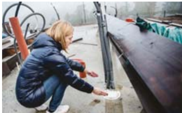
Enligt Kristina Eriksson har den besiktningsfirma de anlät dömt ut rördragningen ur markplattan i villans våtrum.
